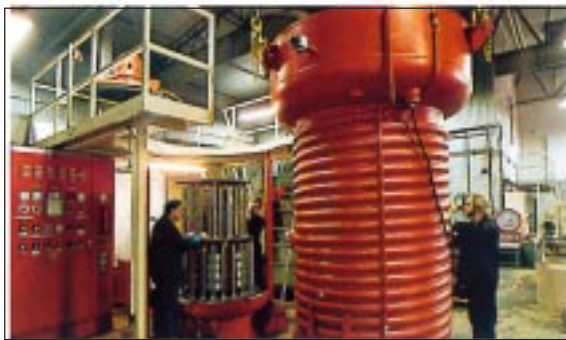
Planta de nitruración iónica.
